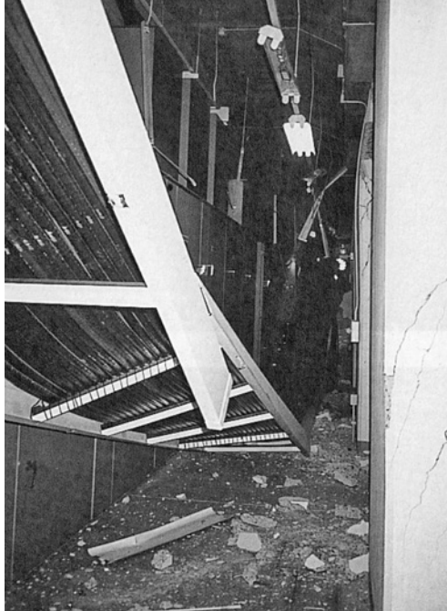
上沢変電所のラックの被害状況
