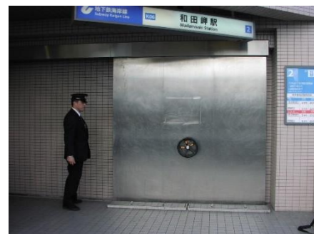
防水鉄扉の操作 （海岸線和田岬駅出入口）
