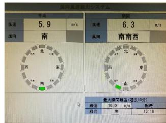
風向風速計表示部（運転指令所）
