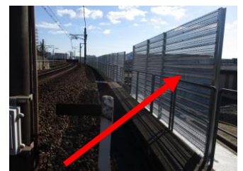
防風柵 （西神・山手線 盛土部分）
