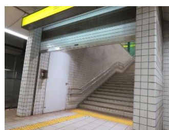
防火シャッター
