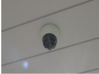
駅構内防犯カメラ
