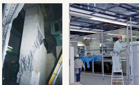
(左) 三宮駅構内中柱の被災状況 (右) 復旧工事の様子 (三宮駅)
