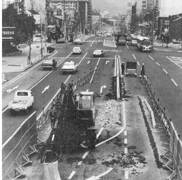
山手線建設工事は大倉山から西に向けて開始された（昭和53（1978）年3月）
